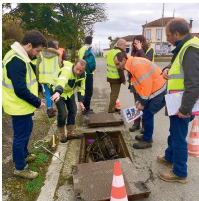
Les élus locaux et départementaux de Tarn-et-Garonne Numérique sont mobilisés depuis le début de l'année pour superviser les interventions d'ORANGE, SPIE et ENGIE sur l'ensemble des sites retenus pour la montée en débit.
